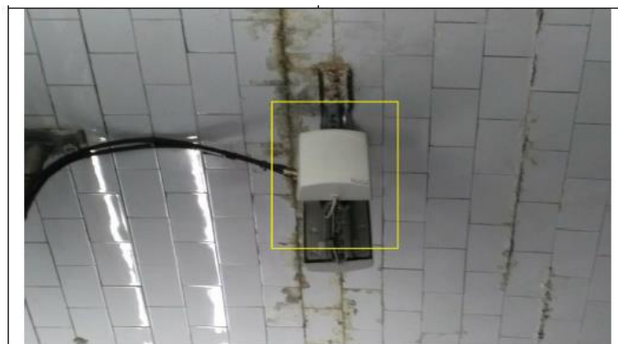
Figure 10. Position de l'antenne (milieu du quai) à la station "Château de Vincennes" (Rapport de mesure R_SO8122_1_1)
